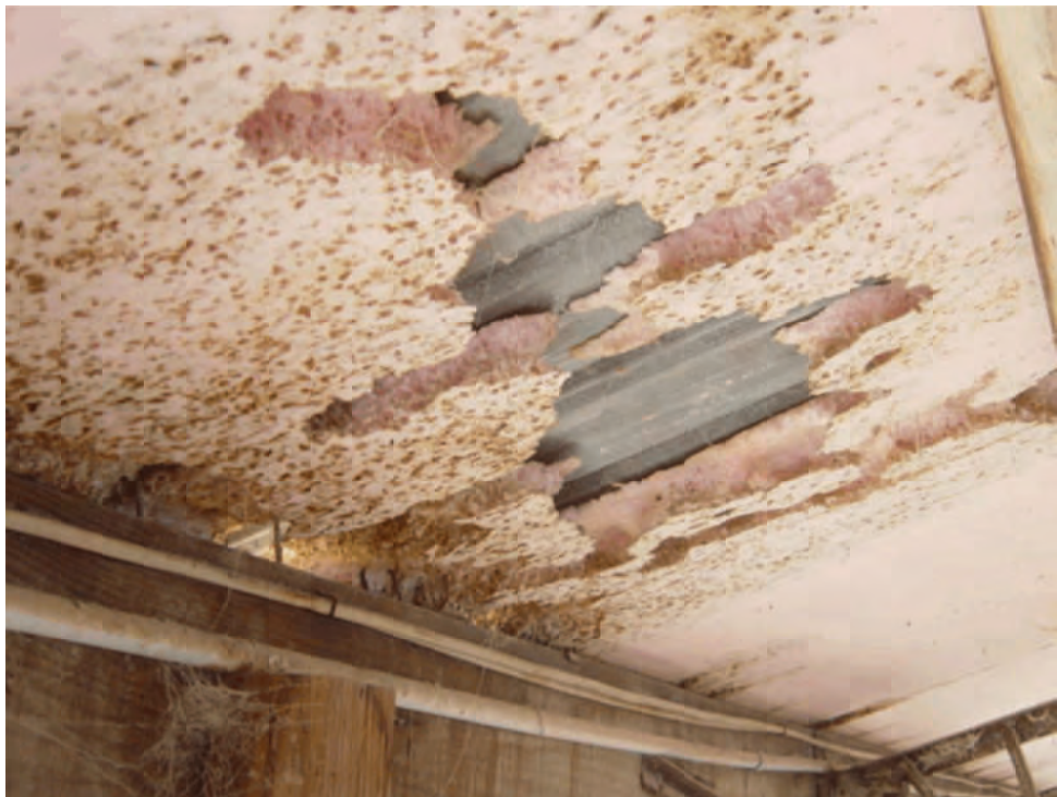
Figura 93. Daños a aislantes térmicos de techos en instalaciones avícolas por Alphitobius diaperinus (Panzer) (276) .
