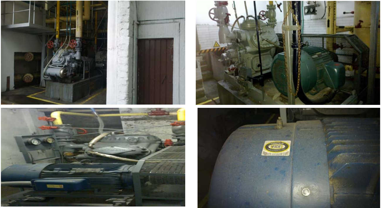
Fig. 3.1 Compresores existentes en la planta de hielo
