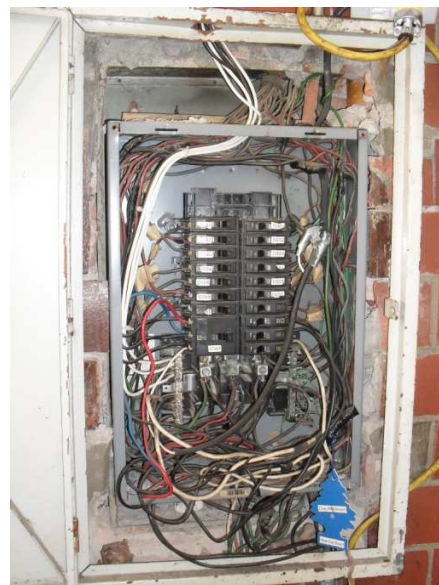
Figura 4.5 Tablero 1D con saturación de conductores
