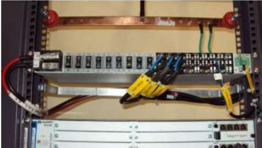
Figura 2.24.- Cables de alimentación DCU - RRU.
