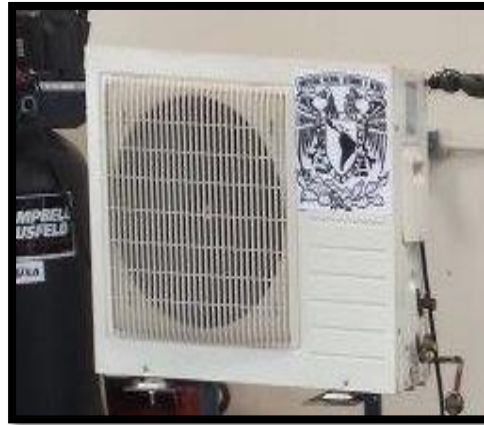
Figura 4. 7 Unidad condensadora del minisplit. 65
