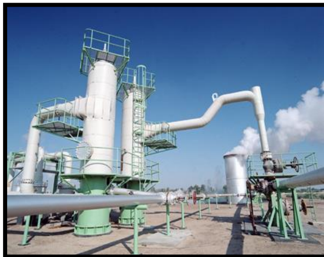
Figura 1. 8 Central geotermoeléctrica de Cerro Prieto 15 .
