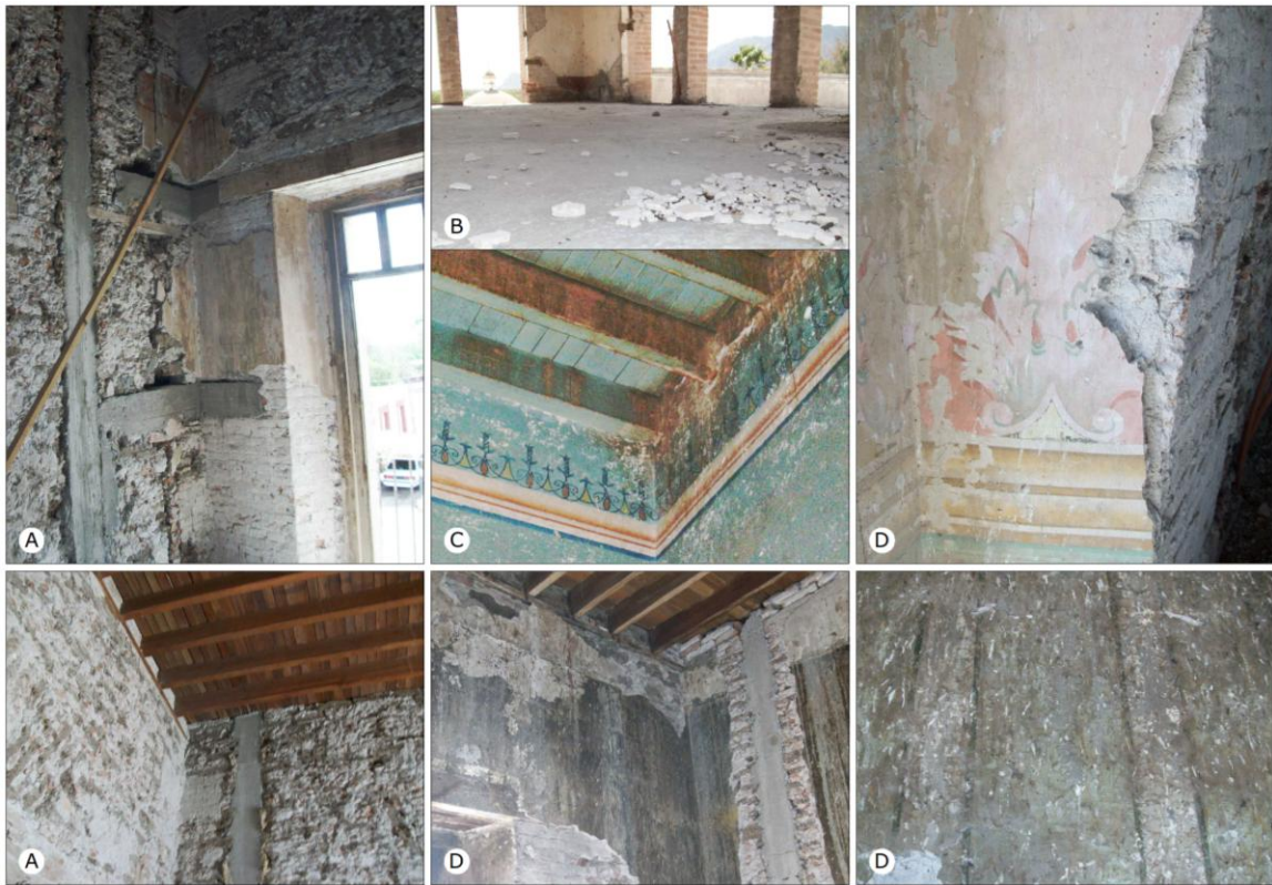
Ilustración 35. Intervención en la hacienda entre los años 2010-2011. (A) empleo de castillos y dalas de concreto para reforzar los muros de adobe, al cual rasparon su aplanado original. (B) reemplazo de sistema original de entepiso y cubierta por losas aligeradas con encasetonado. (C) cenefa pintada en baño, crujía poniente. (D) detalle de ornamentación original en muros de las recámaras en la crujía oriente. Colección particular, año 2011.
