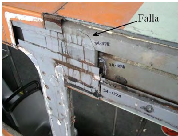
Figura 1.2. Grieta en la esquina superior derecha del marco de la puerta delantera.
