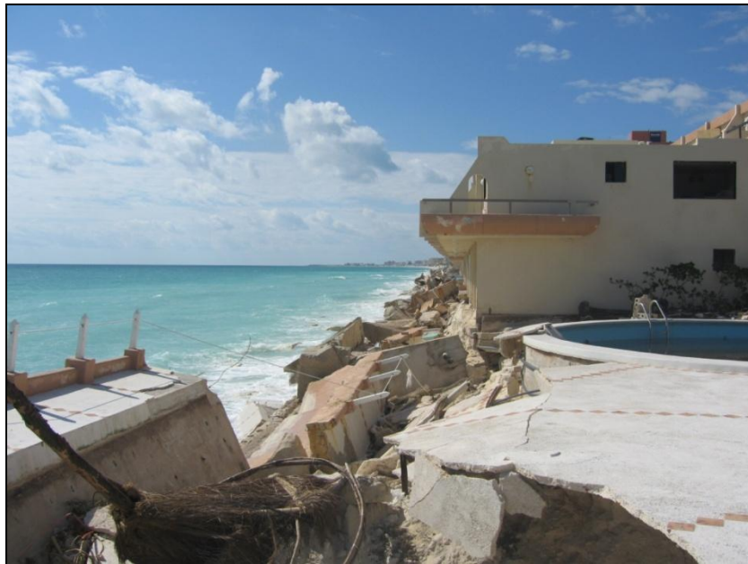
Figura VII.7. Daños a las instalaciones turísticas provocados por el ataque directo del oleaje generado por el huracán Wilma
