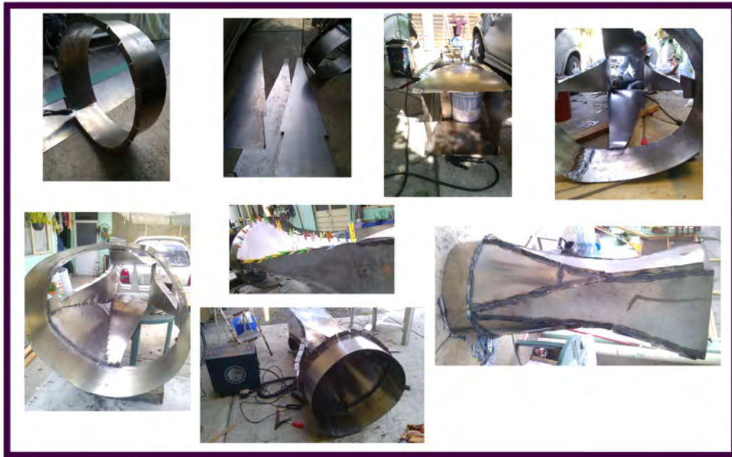
FIGURA 3.3.1. Construcción cronológica del difusor a partir de triángulos de lámina y un pequeño cilindro que embonara en el ventilador.
