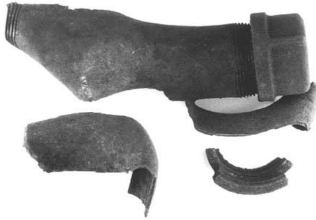
Figura 1. Daño producido a una tubería (10 pulgadas de largo por 1.5 de ancho) causado por pólvora.
