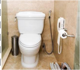
Inodoros de doble descarga
