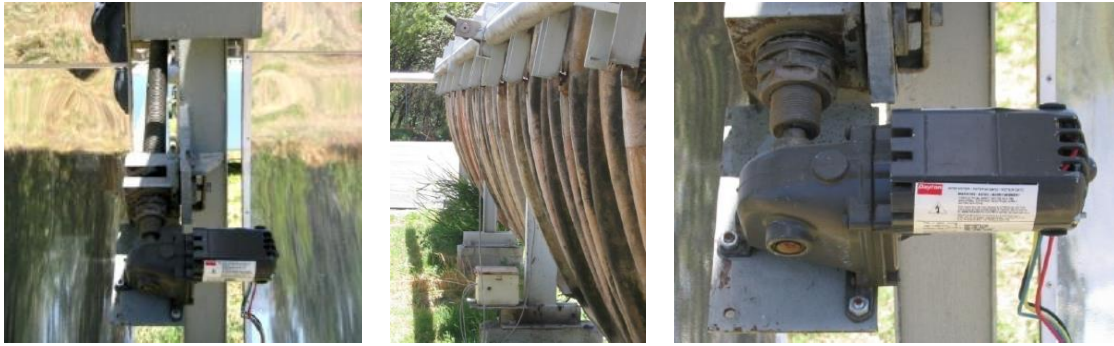
Figura 19. Motor que hace girar la estructura del CCP.
