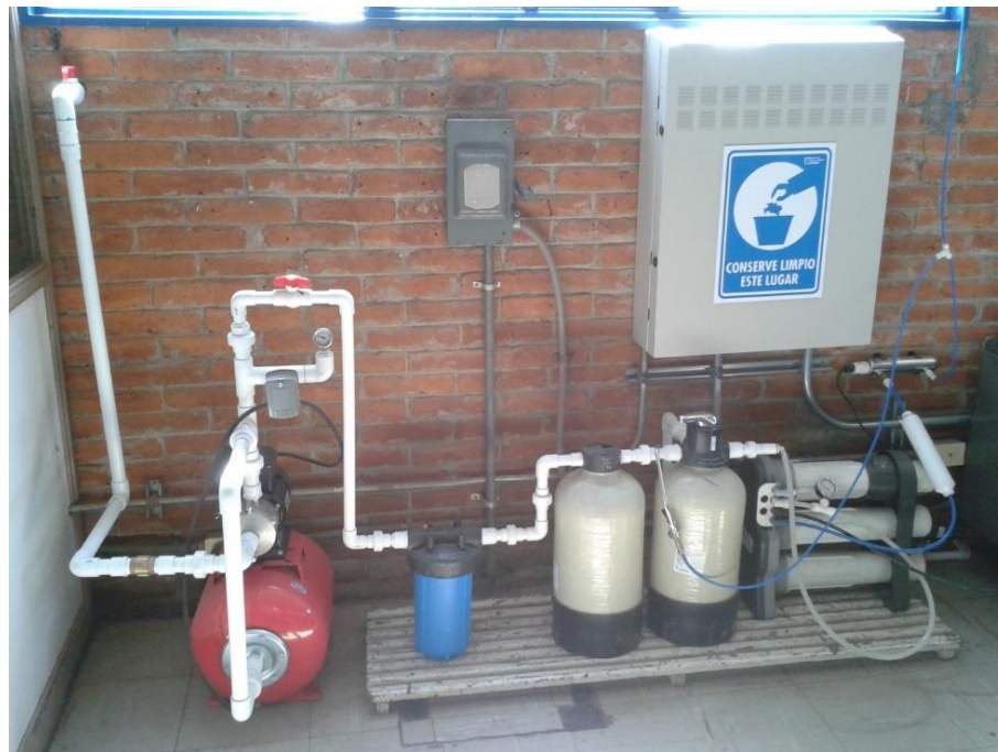
Figura 69. Planta de tratamiento de la Planta Solar del II-UNAM para obtener agua desionizada.
