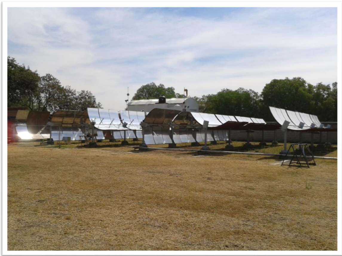
Figura 43. Vista del campo de concentradores de la Planta Solar del II-UNAM.
