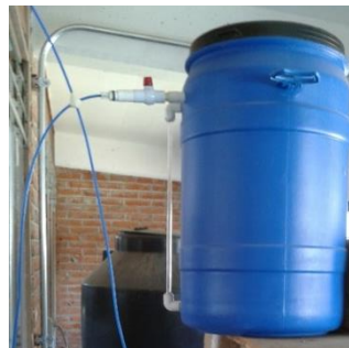
Figura 8. Tanque donde se almacena el agua desionizada en la Planta Solar del II-UNAM.
