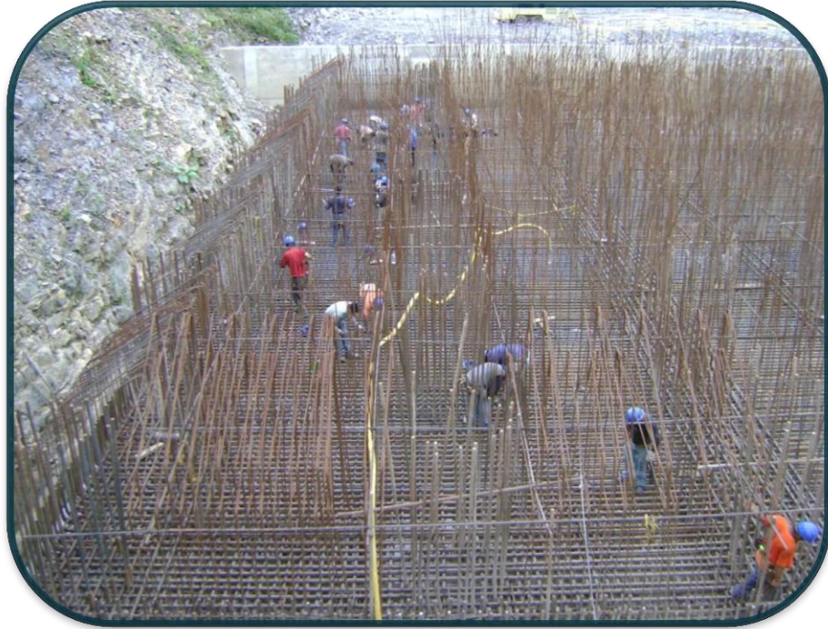
FOTOGRAFIA No.65.-A principio el avance no se veía ya que se tenían 5 camas de acero en el desplante de la zapata.
