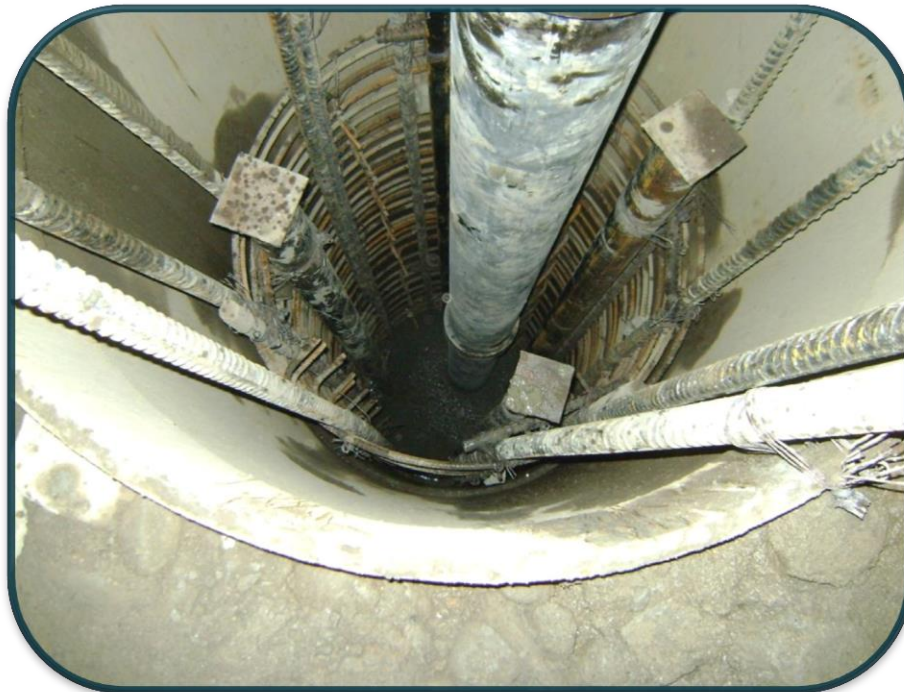
FOTOGRAFIA No.28.-El tubo llega hasta el fondo del pilote y el colado es en forma ascendente.
