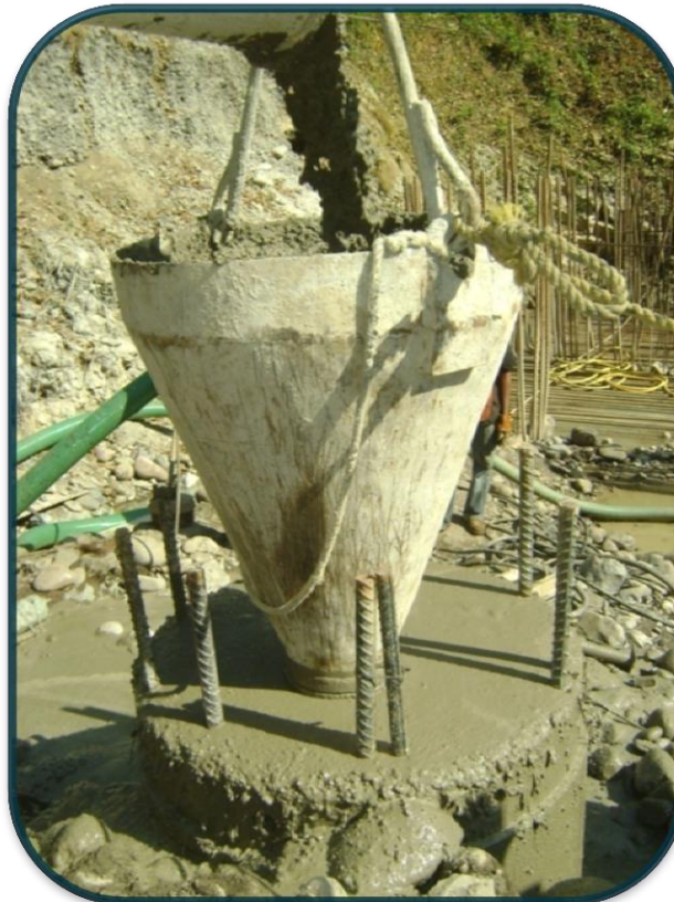
FOTOGRAFIA No.32.-Aproximadamente se desperdicia 1.5 m3 de cada pilote por la contaminación de esta con el suelo.
