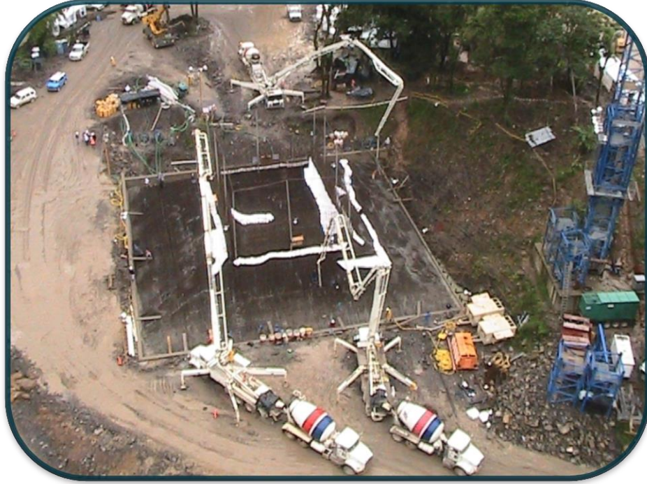
FOTOGRAFIA No.81.-El sentido de transito de las ollas permitió que ninguna bomba quedase sin suministro.
