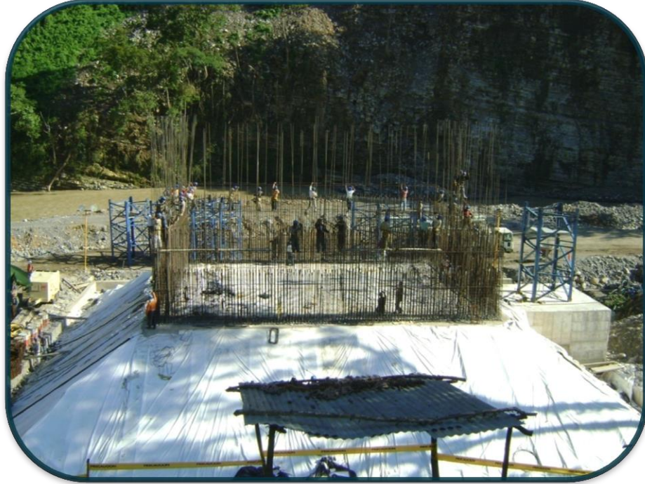
FOTOGRAFIA No.87.-Ya terminado el proceso de colado de la zapata, se monitoreo la temperatura del fraguado para verificar que no rebasara el gradiente durante una semana y se continuo el armado de acero del fuste.
