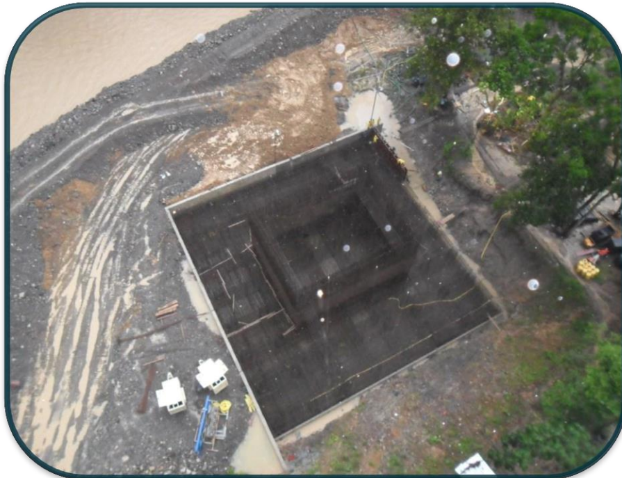
FOTOGRAFIA No.52.-Como la zapata se encontraba a altura del río el nivel freático llegaba a elevarse a nivel del armado.
