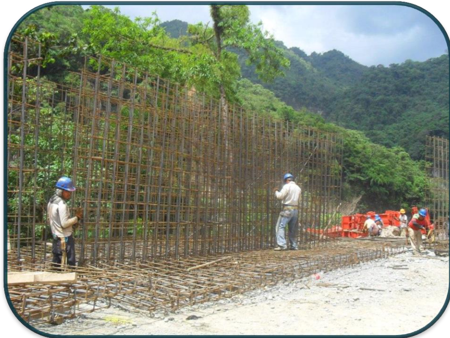
FOTOGRAFIA No.48.-El esqueleto del muro se armó a un lado de la zapata para mayor maniobrabilidad de estos.
