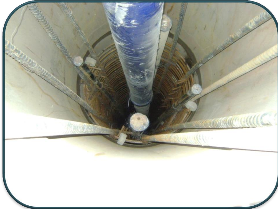
FOTOGRAFIA No.23.-Ya colocado el acero se introduce un tubo tremie que no permite la segregación del concreto vaciado al pilote.
