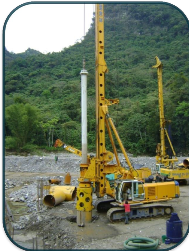
FOTOGRAFIA No.6.-Por cuestiones de rendimiento se utilizaron dos perforadoras de distintas capacidades y en dos turnos.
