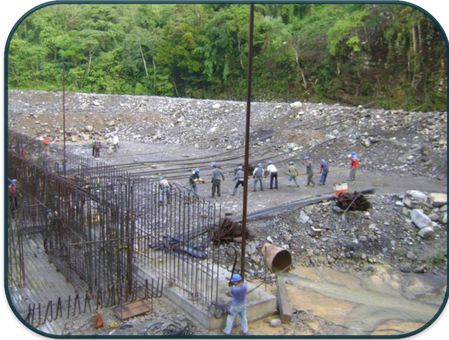
FOTOGRAFIA No.67.-La mayor parte de la colocación de acero se apoyó con la grúa pero en otros elementos no se pudo por el detalle que se entrelazaban parrillas con parrillas.
