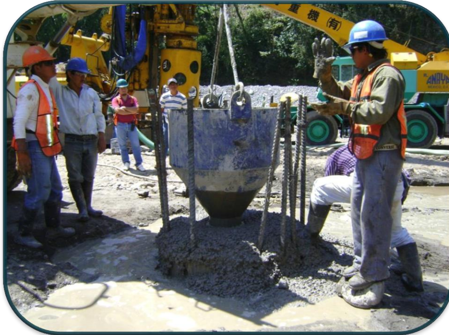
FOTOGRAFIA No.31.-Hasta que el resultado es el concreto limpio y de buena calidad.
