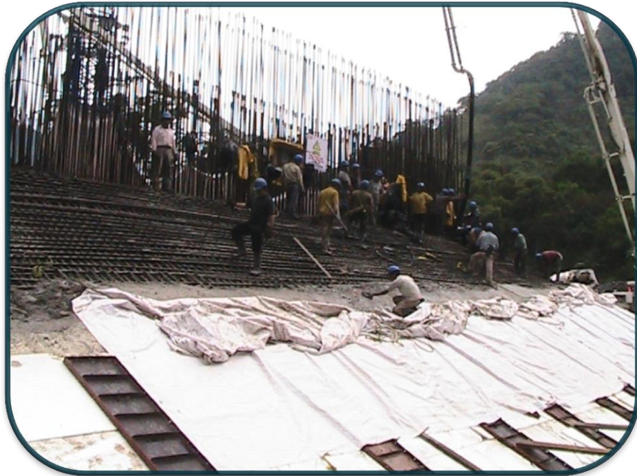
FOTOGRAFIA No.86.-Sobre la membrana de curado y el panel de polipropileno (unicel) se colocaron lonas que mantenía la humedad del colado y no permitió que la lluvia actuara sobre la cara expuesta.
