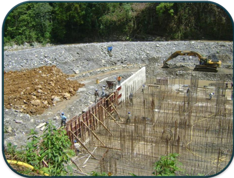
FOTOGRAFIA No.44.-Ya terminado el muro perimetral y siguiendo con los demás módulos se continuaba con la labor de relleno de material a nivel de muro.
