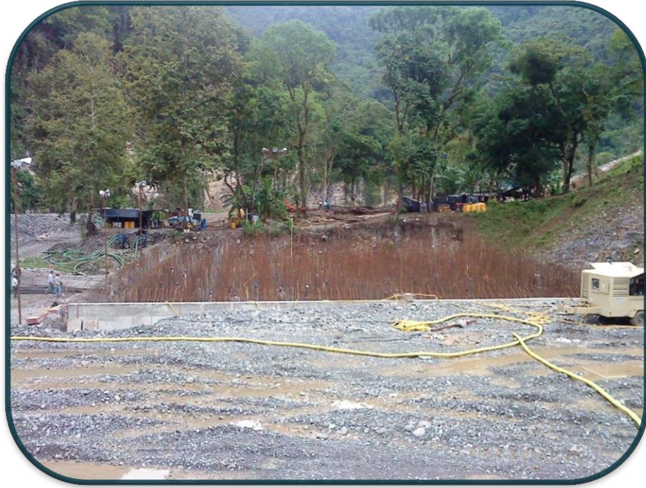
FOTOGRAFIA No.51.-El ataguía que separaba el río de la zapata se mantuvo el nivel hasta el muro perimetral de la zapata.
