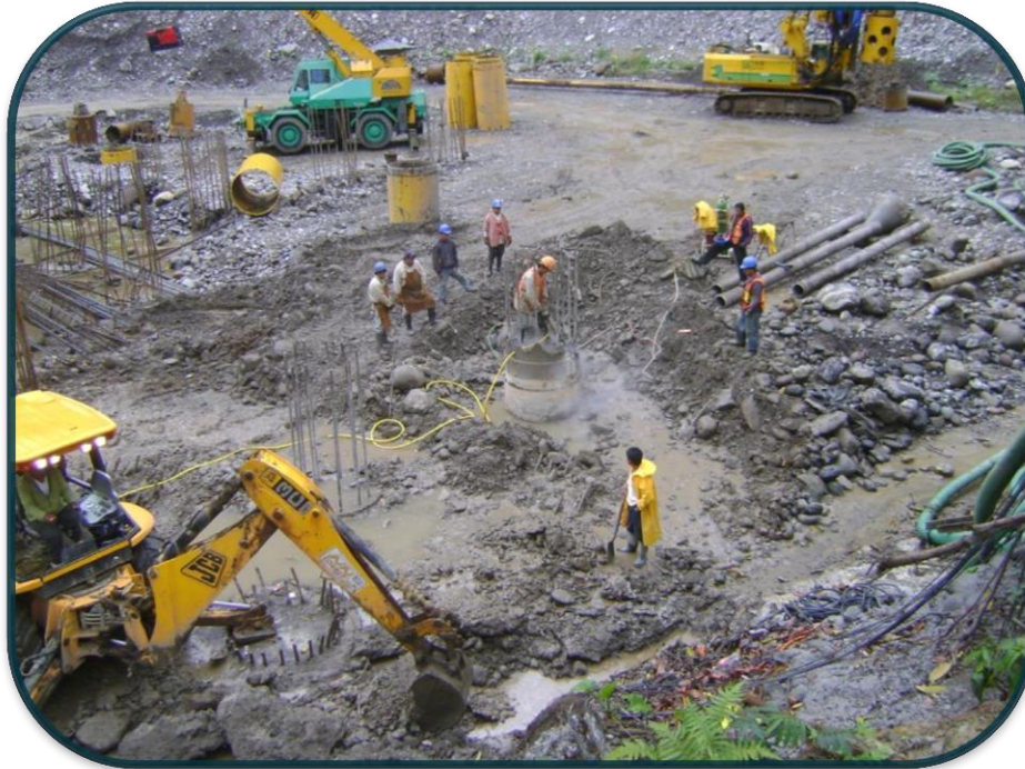
FOTOGRAFIA No.33.-Y como se cometo anteriormente se deja el pilote por lo menos 1m arriba del desplante de la zapata para el descabece de este.
