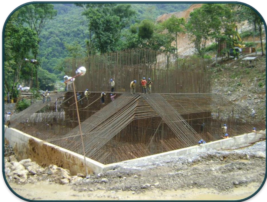
FOTOGRAFIA No.58.-Previo al armado de la zapata se analizo la complejidad de esta y la mejor forma de acoplar esta.
