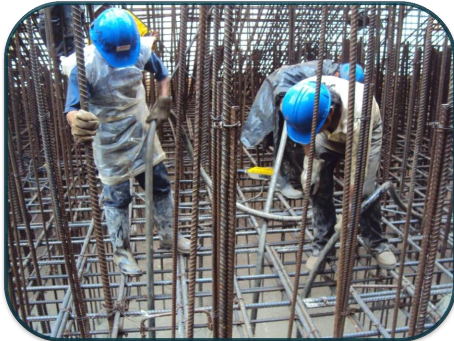
FOTOGRAFIA No.82.-El personal que estaba dentro de la estructura se dedicaba a vibrar ya direccionar el vaciado de la bomba para evitar que segregase este y que se repartiera uniforme.
