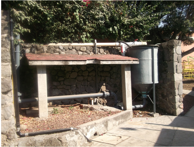
Figura 3.2: Tubería de recirculación, bomba de 4 HP y depósito de agua de 800 l de capacidad.
