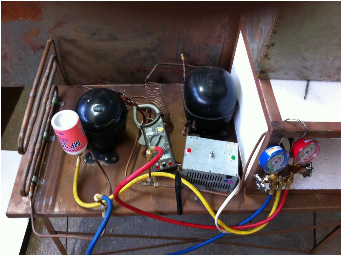
Figura 27. Llenado de refrigerante al sistema
