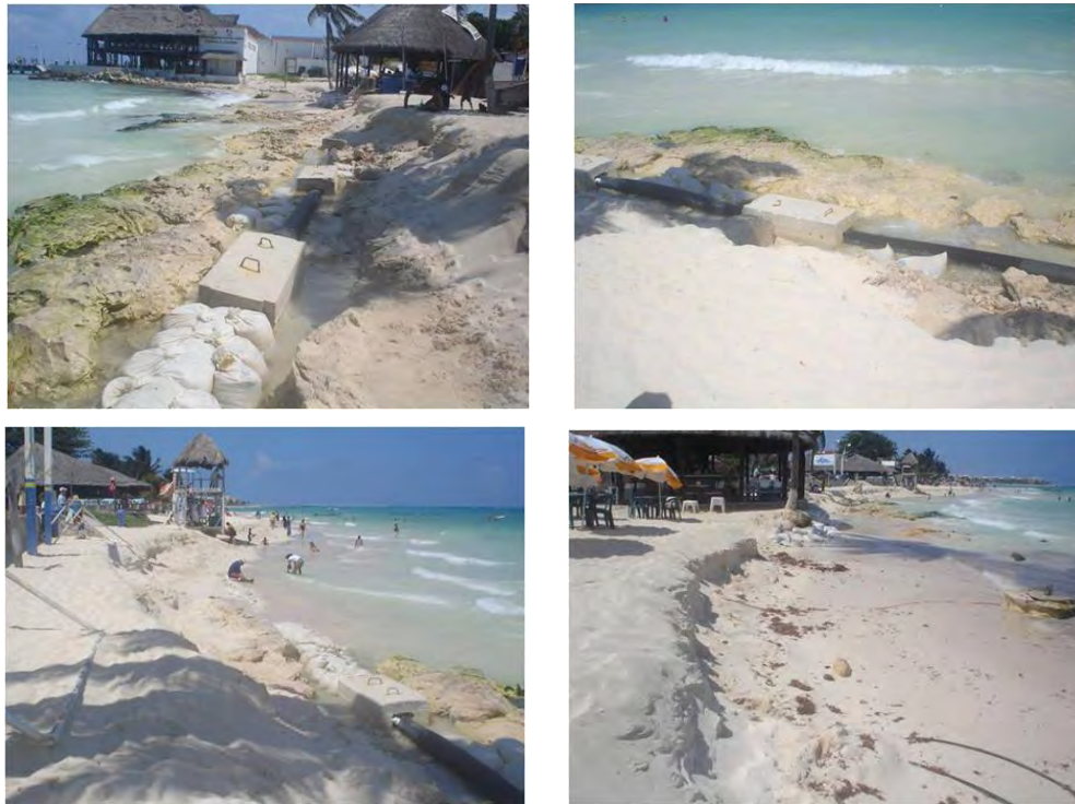
Figura 16. Imagen: efectos de desastre en límite de costa por el huracán Doly
