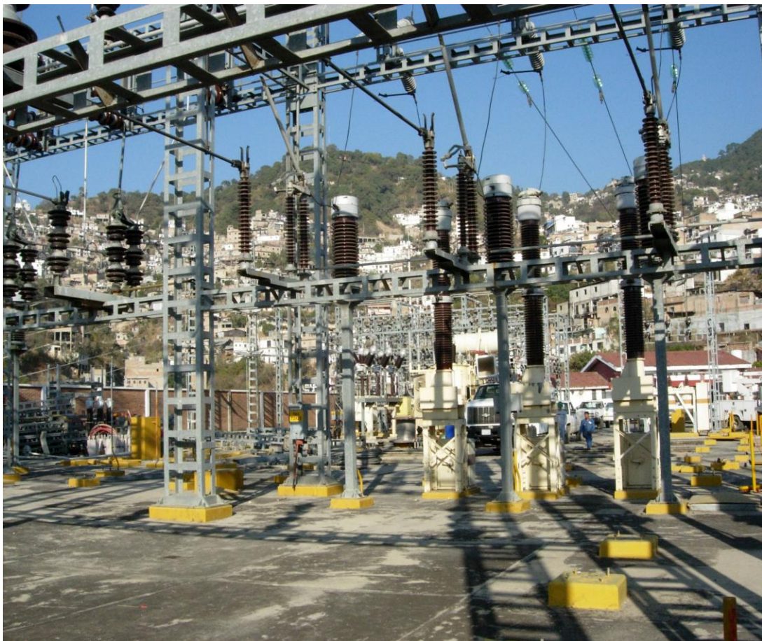
Foto que muestra las condiciones de operación en la existente Subestación Taxco, Bco.1
