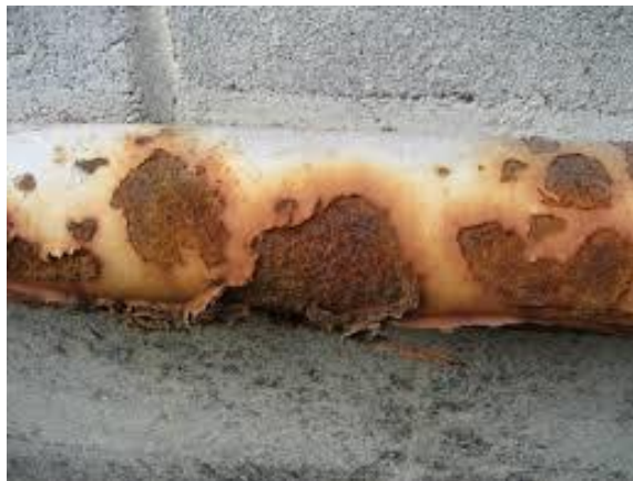
Ejemplo de corrosión.
