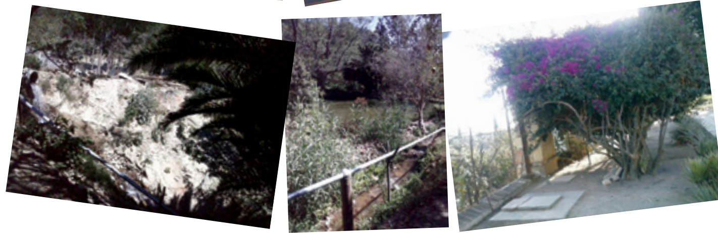
Sistema de Presión de caída del agua hacia pozo mayor para su tratamiento y planta de tratamiento a lado de la bugambilia.
