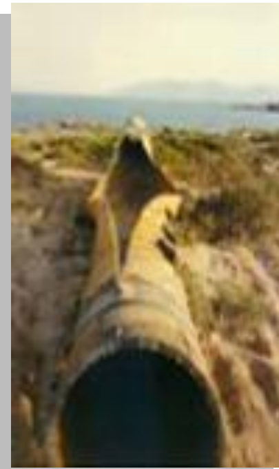
Figura 22. Falla por presión interna.
