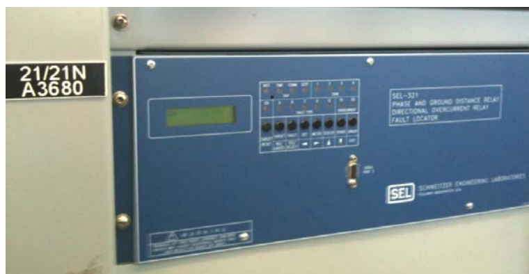
FIGURA 1.2. Fotografía donde se muestra un relevador microprocesado y a su izquierda la nomenclatura 21/21N lo cual nos indica que es una protección de distancia.
