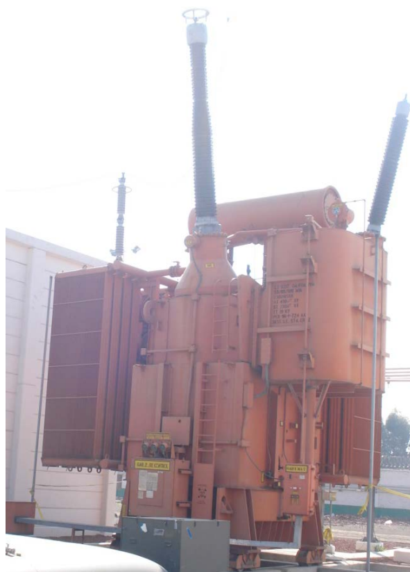
FIGURA 1.13. Autotransformador monofásico con nomenclatura AT421C fase C de S.E. Santa Cruz (CFE).
