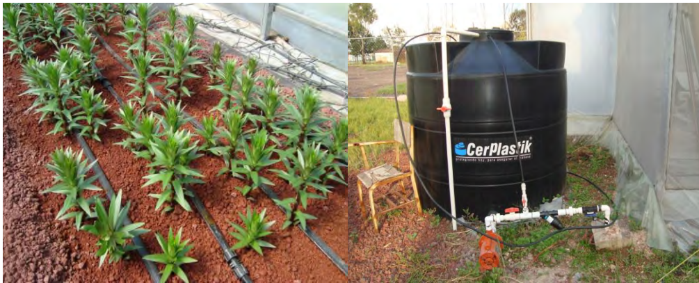
Figura 2.6 Tanque de 2500Lts y línea de riego por goteo
