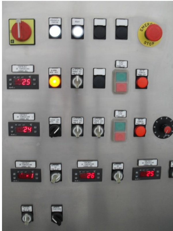
Figura 25. Tablero de control de la Planta Piloto Educativa.
