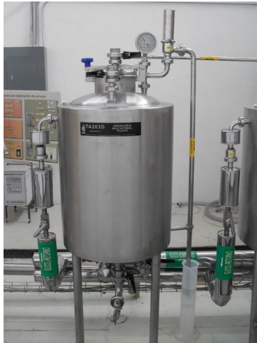
Figura 32. Tanque fermentador SO4/SO5/SO6 de la Planta Piloto Educativa con trampa de CO 2 .
