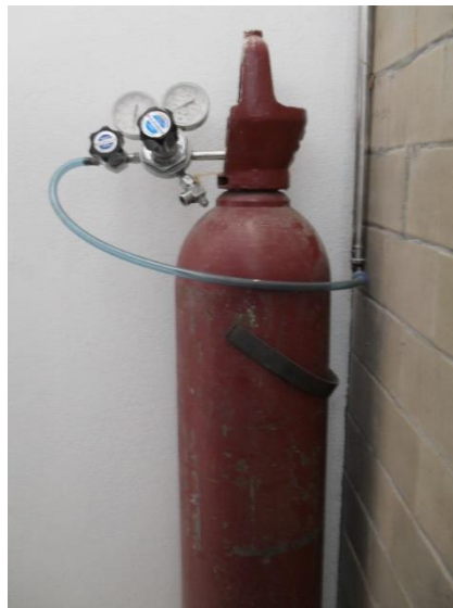
Figura 33. Tanque de CO 2 .
