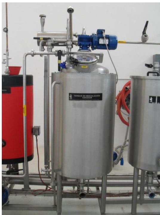
Figura 24. Tanque de cocimiento/sacarificación SO2 de la Planta Piloto Educativa para elaborar Cerveza modelo TA263D.
