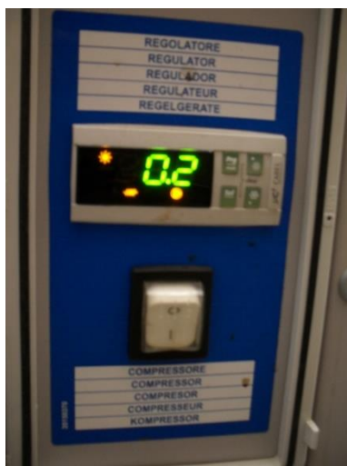
Figura 30. Control electrónico del compresor.
