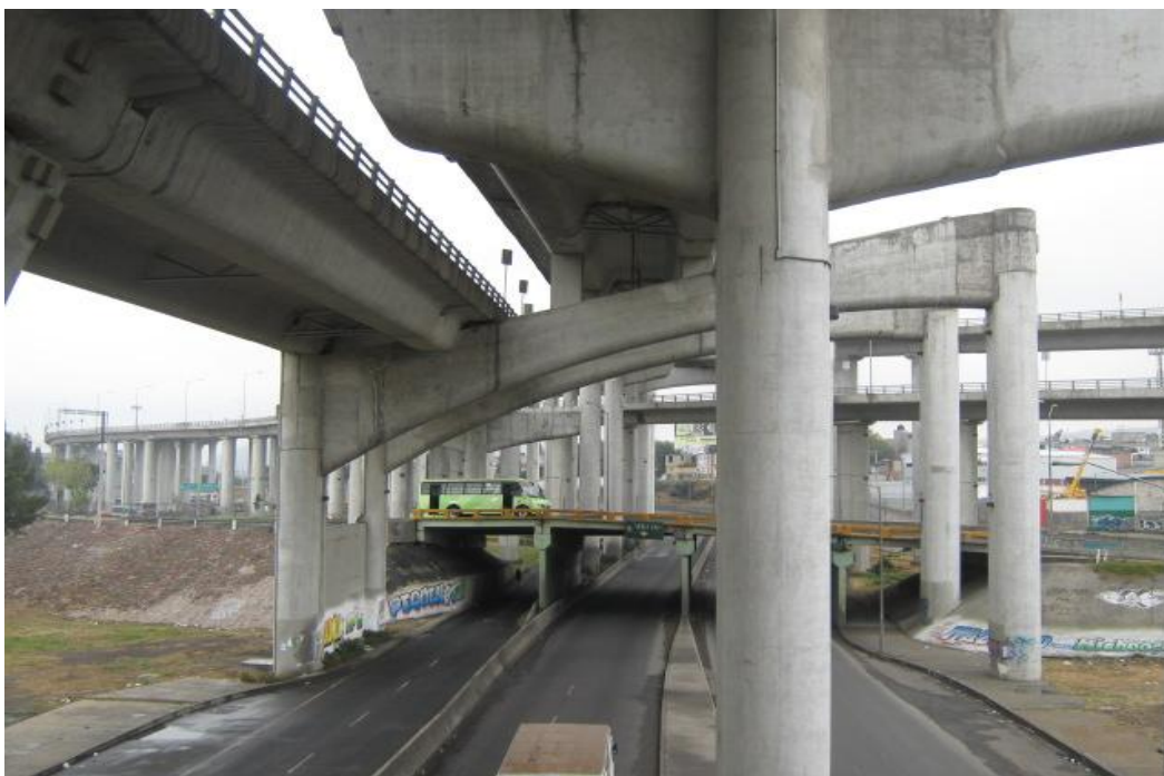
Figura 1.26 Marco de rigidez a base de columnas y traves de concreto presforzado
