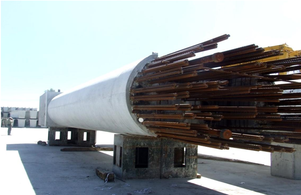
Figura 1.30 Columna de concreto presforzado, construida en planta, que fue colocada en el Distribuidor vial Zaragoza-Texcoco
