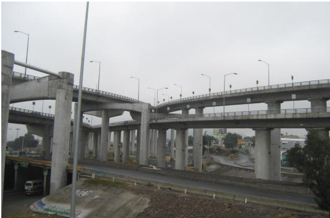
Figura 1.28 Marcos de rigidez a base de columnas y traves de concreto presforzado
