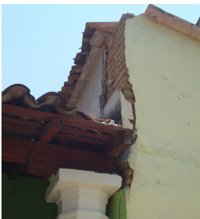
Imagen 102. Daños en casas de la Costa de Oaxaca después del sismo del 20 de marzo del 2012
