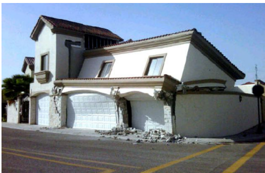
Imag. 9 Sismo en México 2003. Casa en Mexicali
