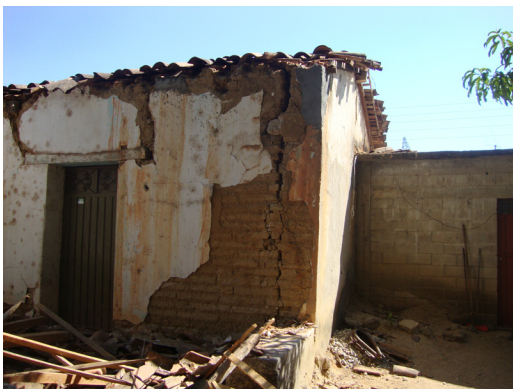
Imagen 63 b. Casa de adobe en Cacahuatpec, Oaxaca después del sismo del 20 de marzo del 2012
