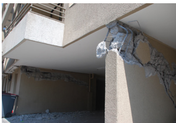
Imag. 96 Grieta en edificio Regina Oriente, por falta de confinamiento del concreto
