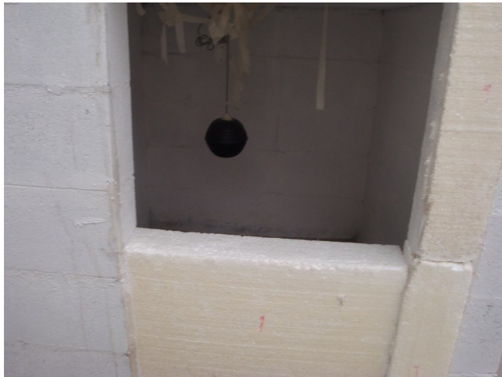
Fig.110. Montaje experimento IX. Se cierran los módulos con paneles de Poliestireno. Fuente: Propia
