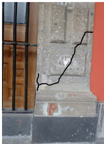
Figura 2.8 Agrietamientos en elementos de cantera, marco de ventana en el Patio Central
