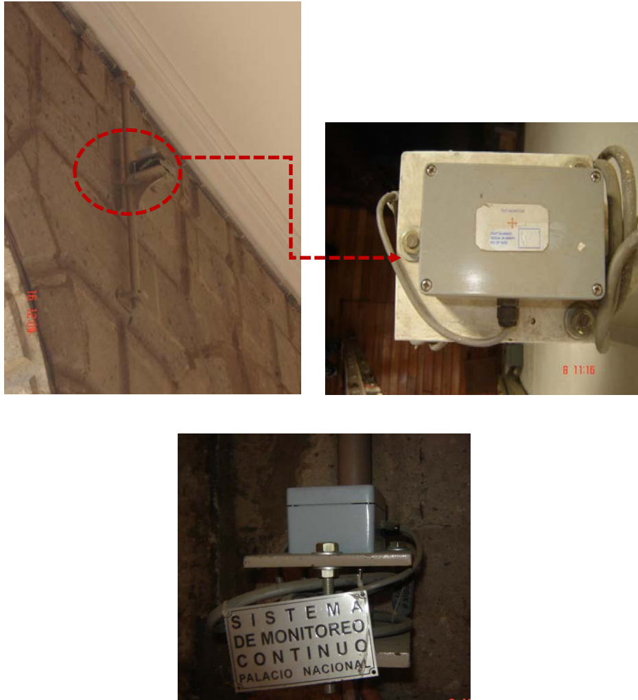
Figura 3.5 Inclinómetros instalados en Palacio Nacional.
