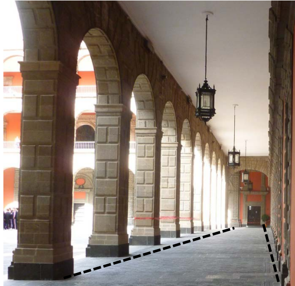
Figura 2.9 Desniveles en columnas, costado norte del Patio Central.
