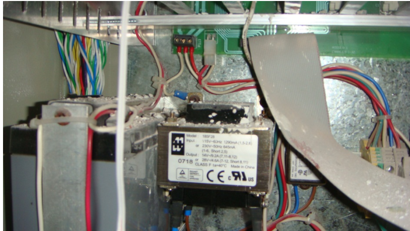
Figura 5.7 Interior de la estación 8, presencia de escombros y polvo
