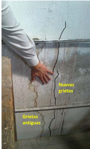
Figura 5.3 Detalle de agrietamientos bajo los extensómetros 3 y 7
