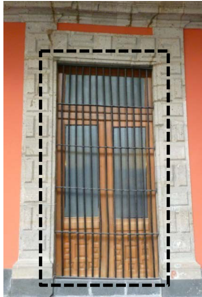
Figura 2.7 Marco y herrería de ventana con deformaciones, Patio Central.
