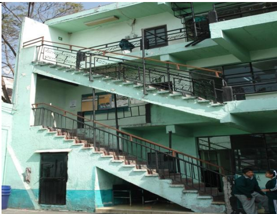
Ilustración 5 Pasillos y escaleras no cumplen con dimensiones
