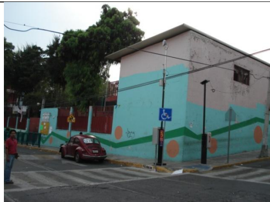
Ilustración 22 Pintura en mal estado
