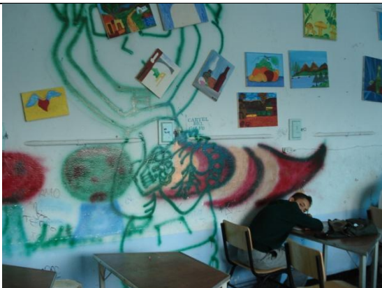
Ilustración 11 Pintura en pésimo estado
