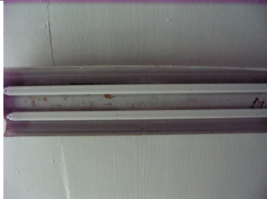
Ilustración 8 Luminarias fuertemente maltratadas
