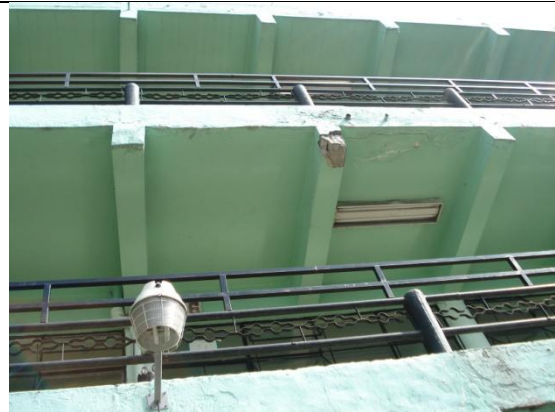
Ilustración 4 Agrietamiento en vigas
