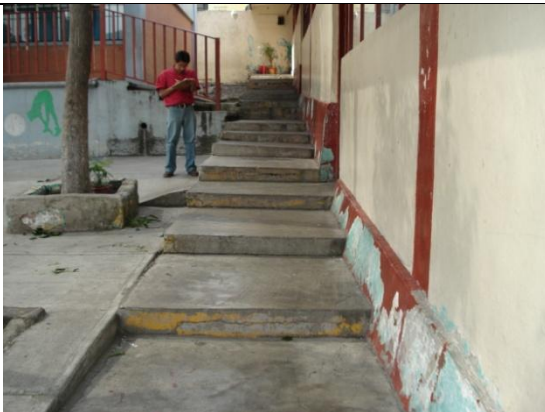
Ilustración 15 Escalera con ligero asentamiento hacia el edificio y presenta agrietamiento de concreto
