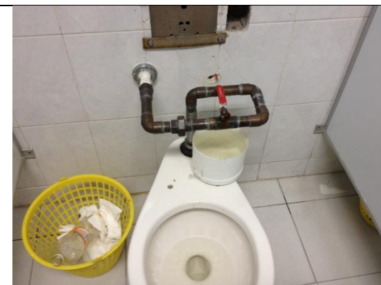
Ilustración 18 Filtraciones en tuberías
