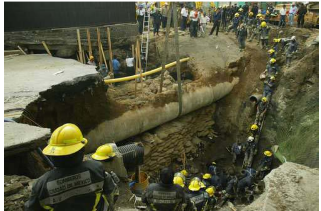
Fig. 14 La grieta mostrada en esta fotografía es uno de los hundimientos más impresionantes que ha ocurrido en la ciudad como consecuencia de la sobreexplotación del acuífero.
