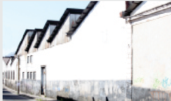
Fábrica La Providencia. Fue de empleo para muchos uruapenses en periodos antiguos de la ciudad. Actualmente se encuentra abandonado el edificio e incluso deteriorado.
