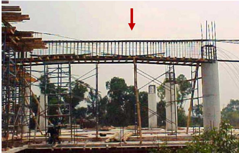
Figura 2.9 Detallado deficiente en la zona del vértice
