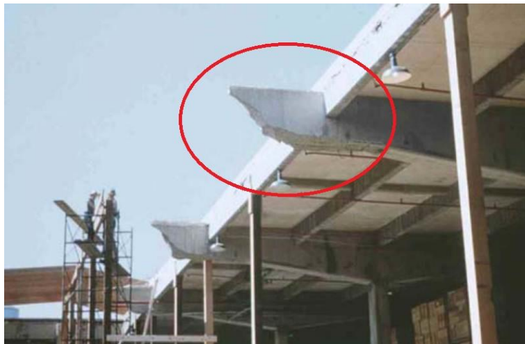
Figura 2.4 Falla por cortante en traves acarteladas ocurrida en Estados Unidos a mediados del siglo pasado (tomada de Collins et al. 2007)
