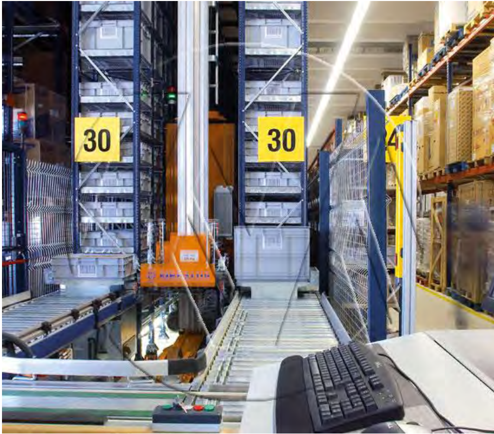
Figura 1.15. Almacén automático manejado por computadora.
