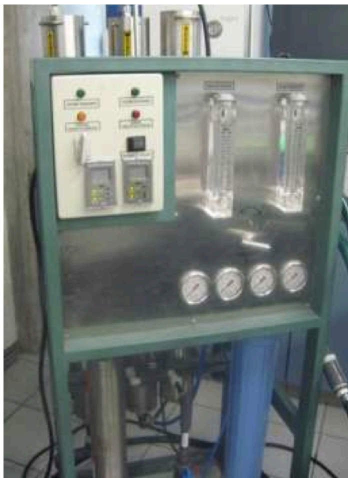
Figura 29. Módulo de membranas de nanofiltración operado.
