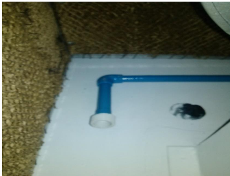
FIGURA 2.28 FOTO CONEXIÓN A BOMBA.
