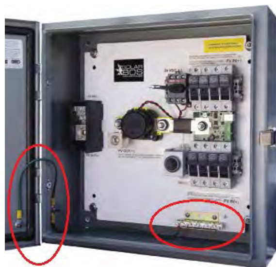
Figura 52. En esta caja combinadora se resaltan la terminal de los conductores de tierra (derecha) y los puntos de puesta a tierra de la caja y su tapa (izquierda), así como sus puentes de enlace.
