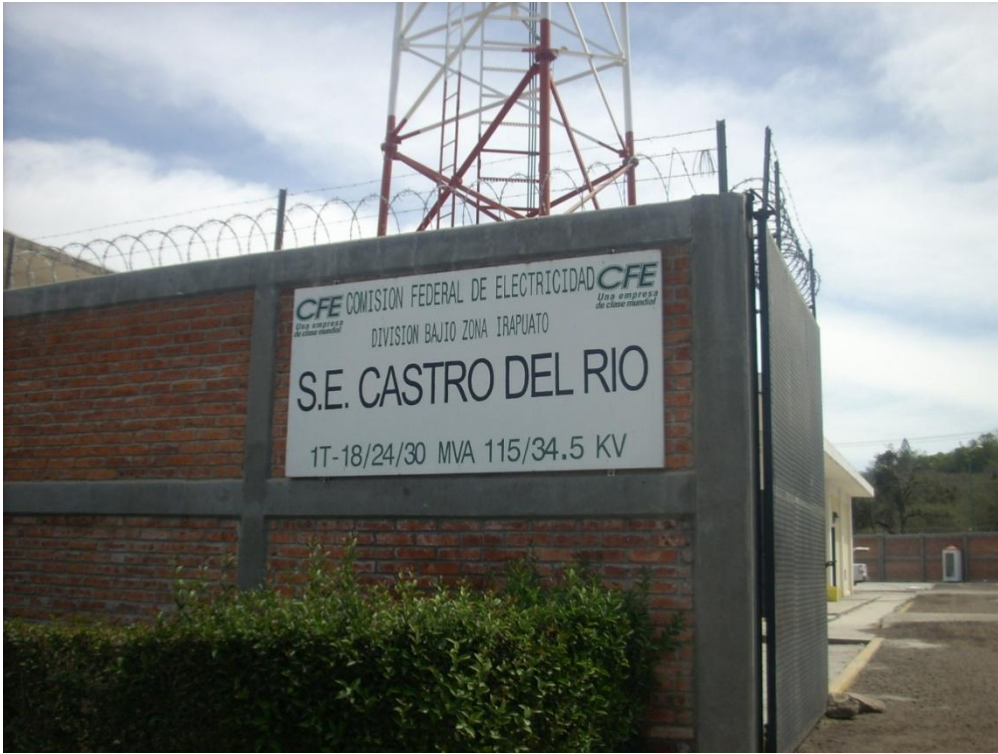
Imagen 17. Vista de la planta eléctrica de "Castro del Río" (Fuente: Rodrigo Sandoval).
