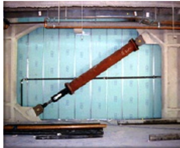
Gráfico N° 30 (Amortiguador viscoso instalado en la estructura.).
