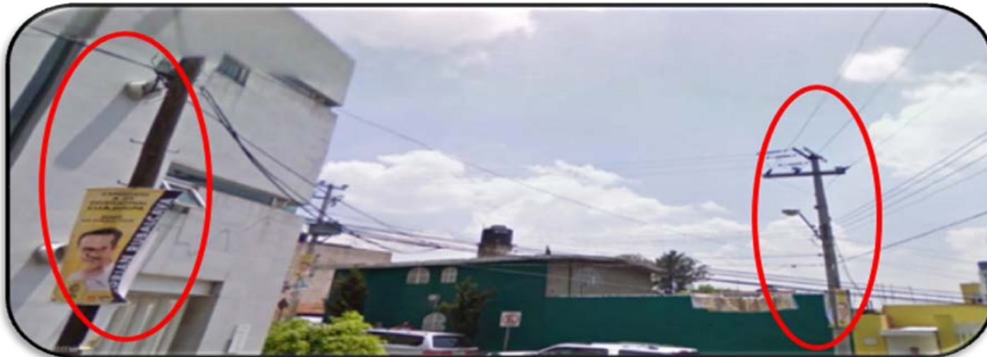
14 Imagen 15 Colonia Lomas el Chamizal La imagen muestra la red eléctrica, el alumbrado público y la red telefónica.
