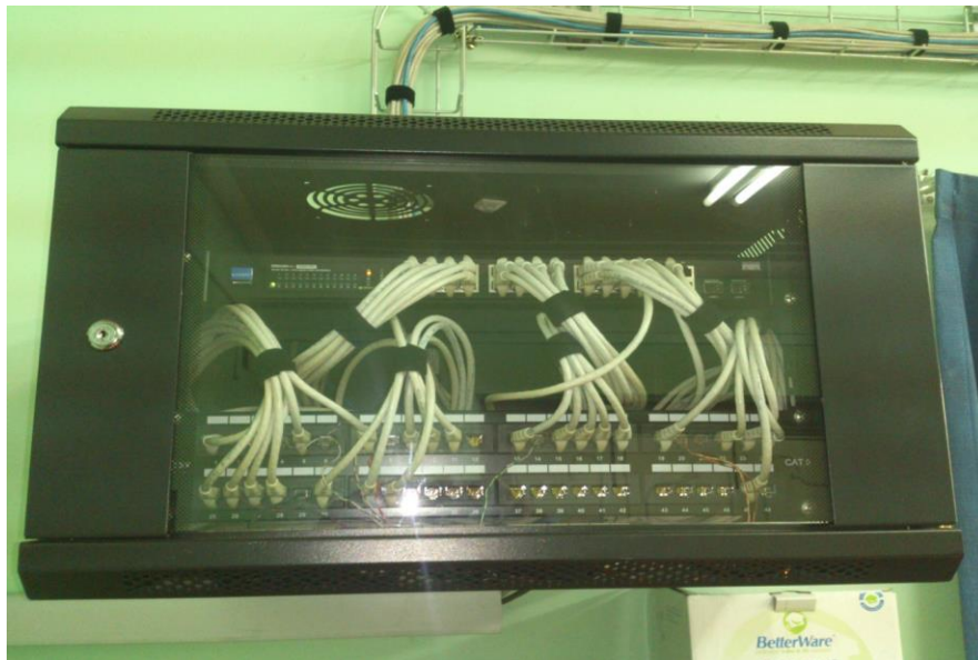
Figura 6.4.13 Gabinete de comunicaciones en Sala de Maestros
