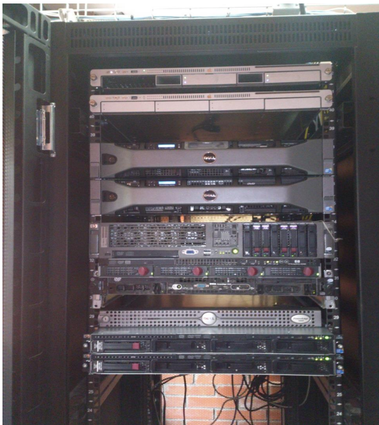
Figura 6.4.8 Servidores instalados en el Rack de RDI
