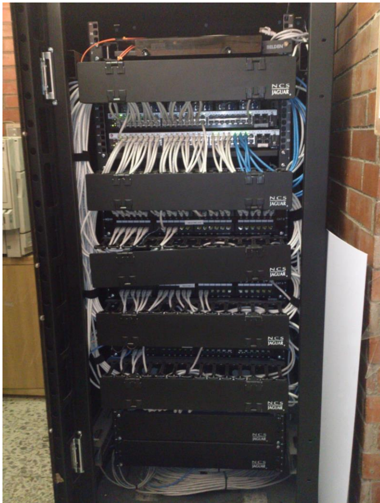
Figura 6.4.11 Rack de Comunicaciones localizado en la Sala de Macintosh
