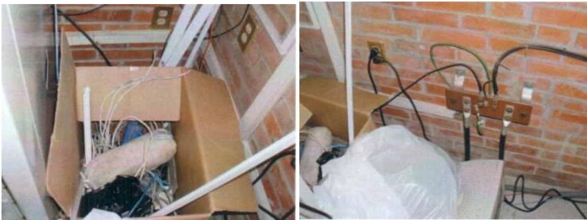
Figuras 6.1.8.24 y 6.1.8.25 Condiciones del cableado localizado en RDI
