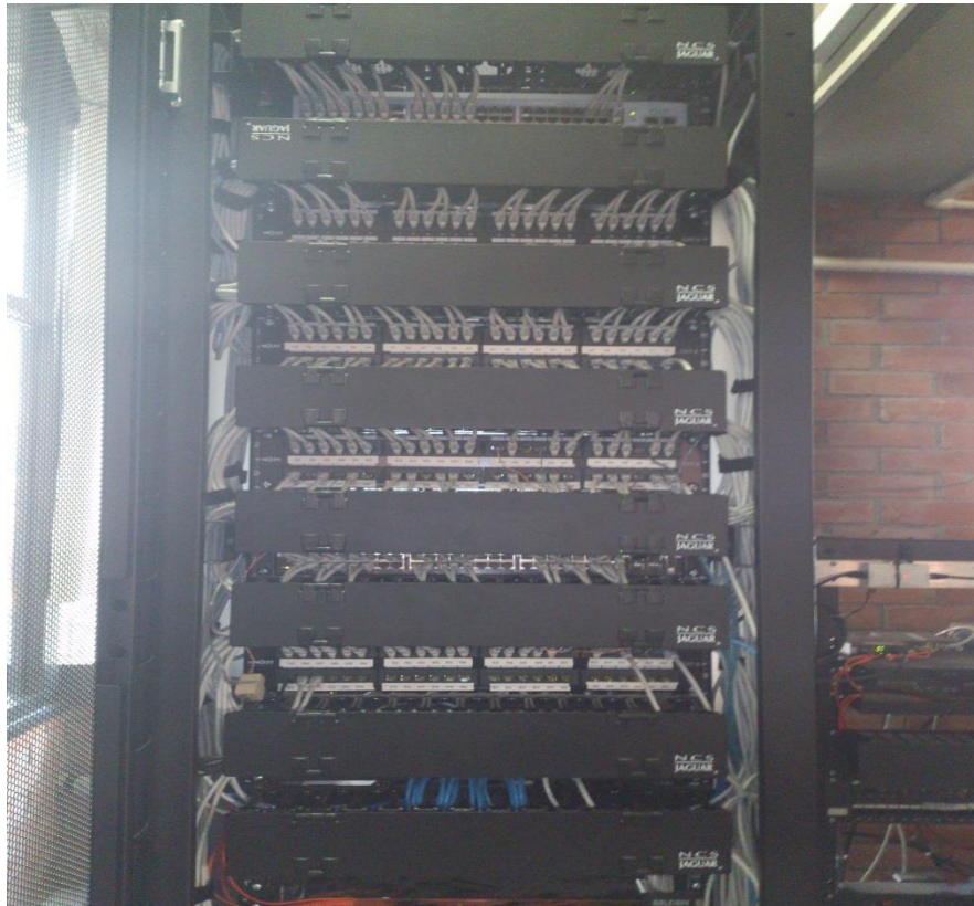
Figura 6.4.1 Rack de Comunicaciones localizado en CTI
