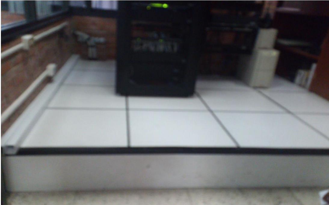
Figura 6.4.3 Piso falso del Site de CTI
