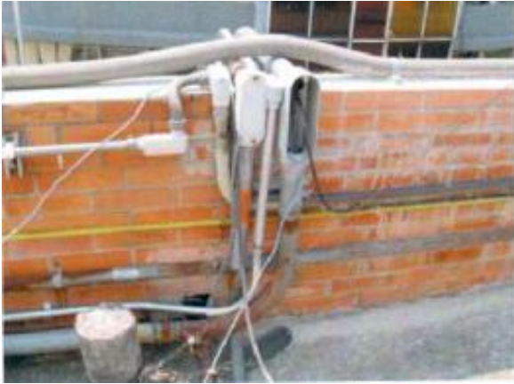
Figura 6.1.8.34 Tubería oxidada en la azotea de la Universidad
