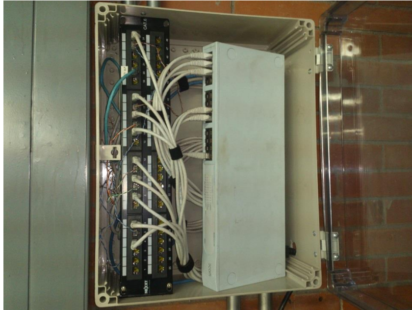
Figura 6.4.5 Gabinete instalado en planta piloto
