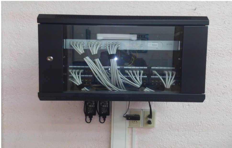
Figura 6.4.10 Gabinete localizado en Biblioteca
