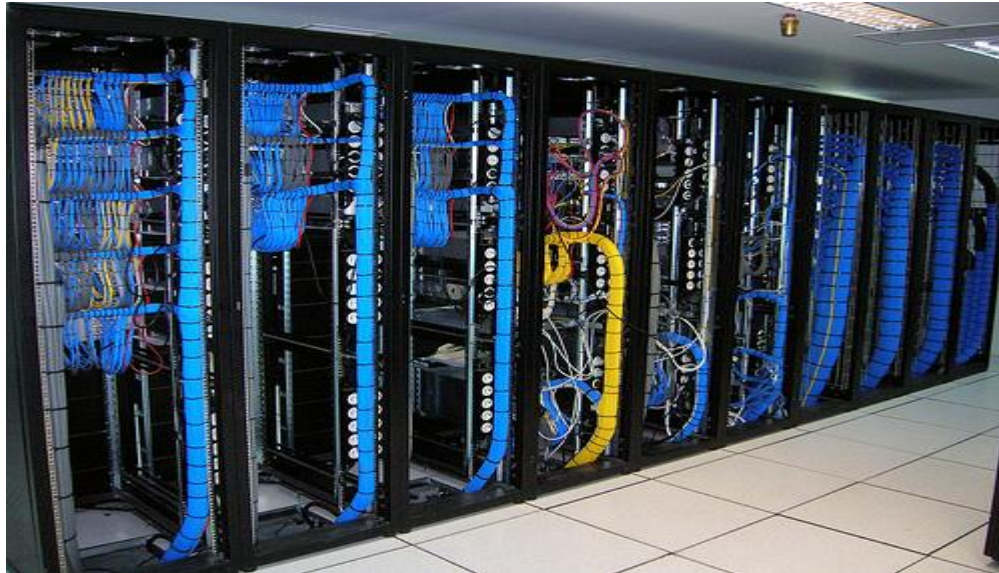
Figura 4.3.3 Un cuarto y varios equipos de telecomunicaciones.
