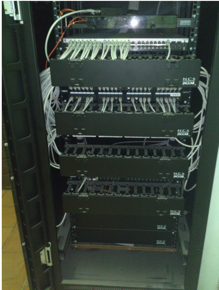
Figura 6.4.12 Rack de Comunicaciones de Rectoría
