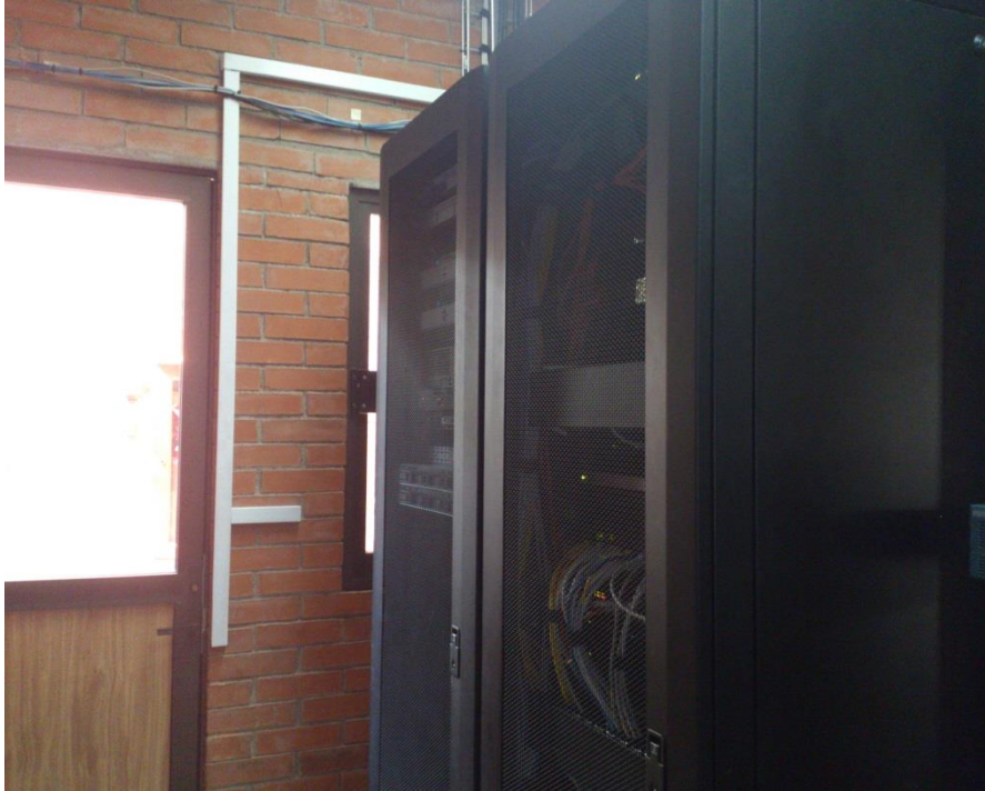
Figura 6.4.6 Gabinetes instalados en el Site de RDI
