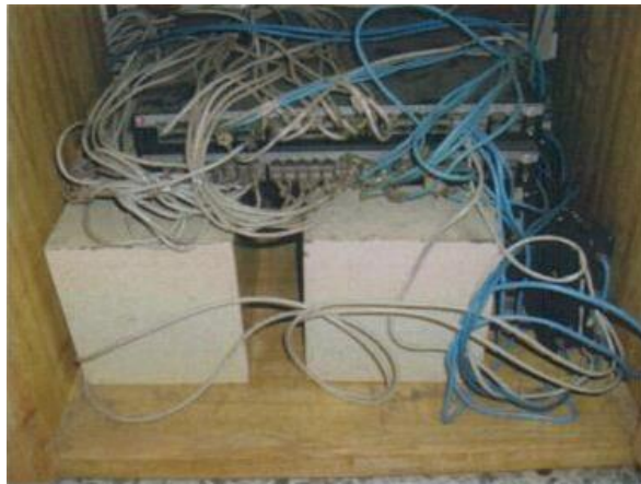
Figura 6.1.8.20 Switches y cableados en sala MAC 1
