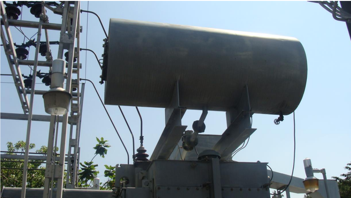
Tanque conservador (Fig. 1.3)
