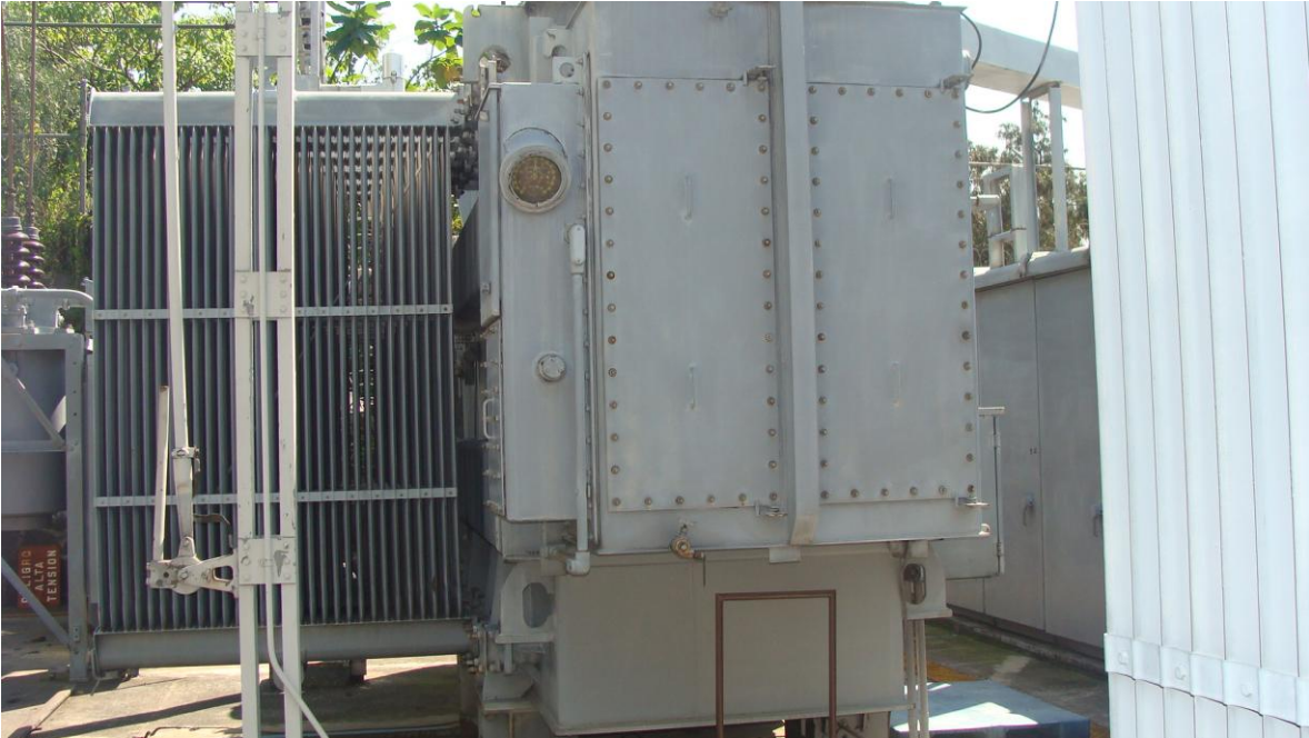
Cambiador de derivaciones (Fig. 1.5)
