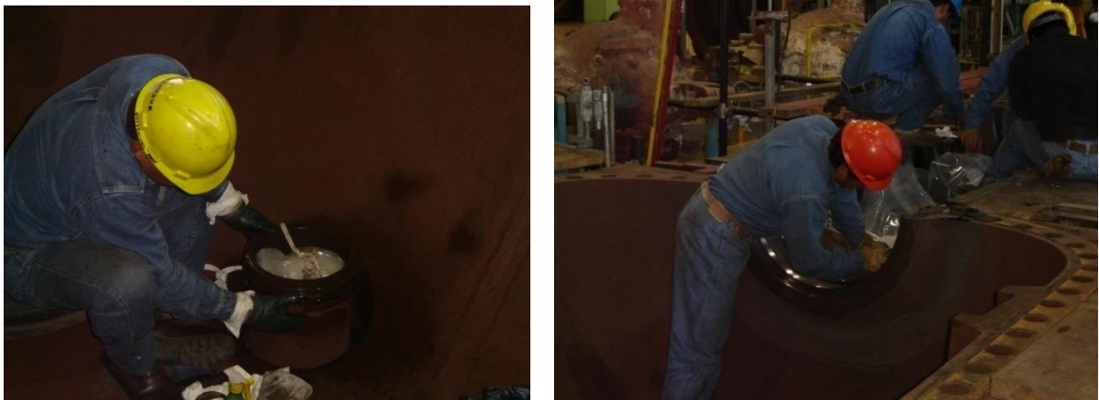
Figura 4.15 Limpieza de soportes de chumaceras y de la boquilla de entrada de vapor.
