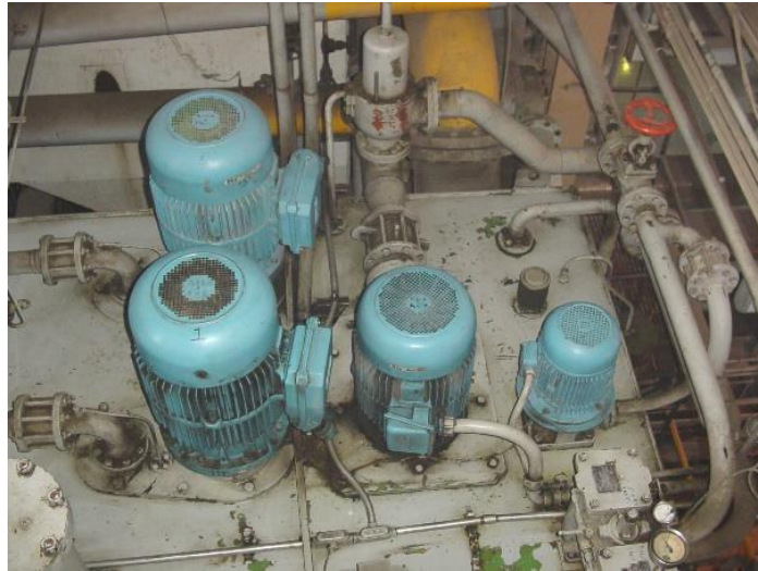
Figura 3.11. Sistema de bombas auxiliares.
