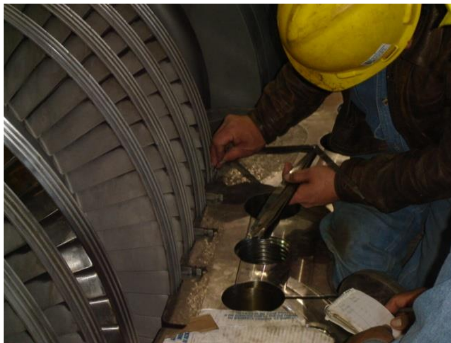
Figura 4.58 Mediciones a rotor de turbina de vapor.
