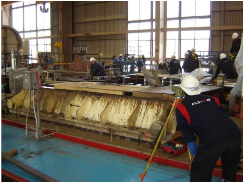
Figura 4.51 Toma de altimetría en carcasa inferior de baja presión.
