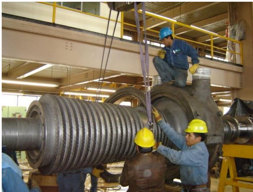
Figura 4.60 Retiro de anillos de tobera.
