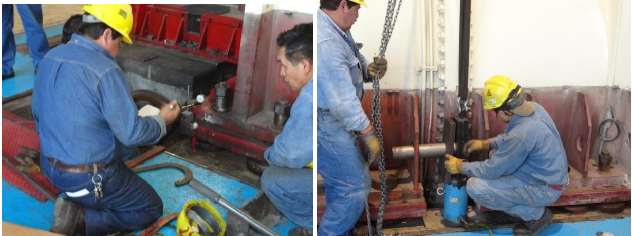
Figura 4.87 Toma de lecturas después de mover el generador eléctrico.
