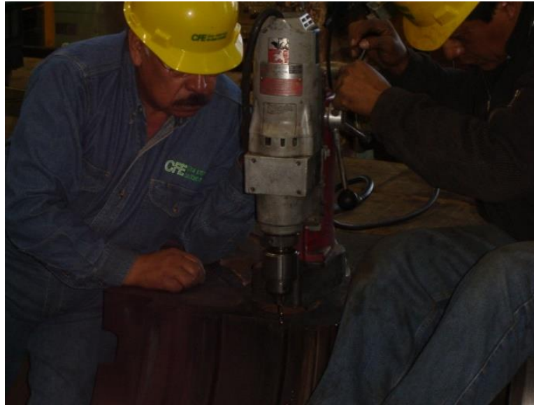
Figura 4.16 Retiro de tornillería fracturada
