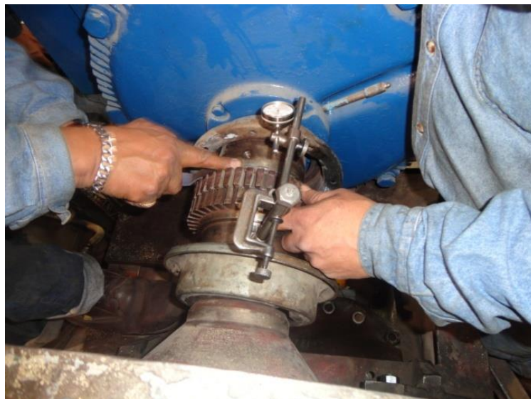
Figura 4.91 Alineamiento de motor de torna flecha
