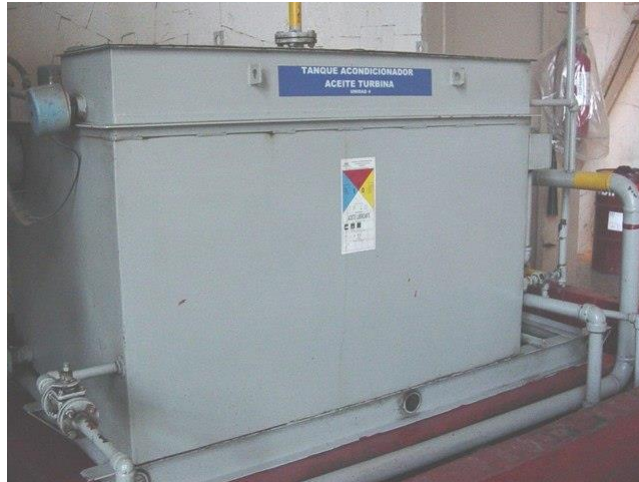
Figura 3.10. Tanque de acondicionamiento.
