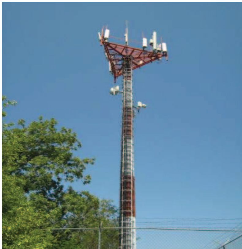
Figura 4.21 Antenas instaladas en lo más alto de la torre.
