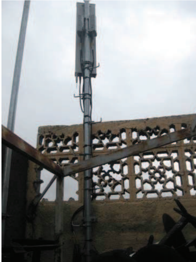
Figura 4.39 Reubicación de una antena.
