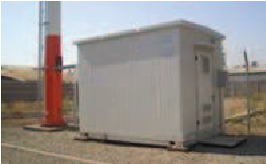
Figura 3.33 Caseta para el equipo de radio base.
