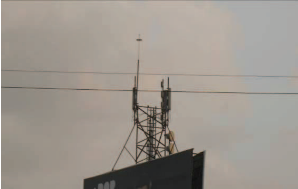
Figura 3.18 Ejemplo de obstrucción por otros equipos.
