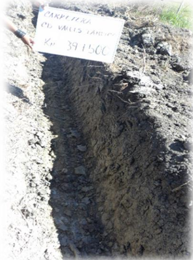
Figura 4.11. Vista "in-situ" del PCA ubicado en el Km 39+500. Fuente: Secretaría de Comunicaciones y Transportes.
