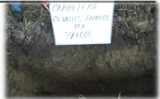
Figura 4.8. Vista "in-situ" del PCA ubicado en el Km 37+000. Fuente: Secretaría de Comunicaciones y Transportes.
