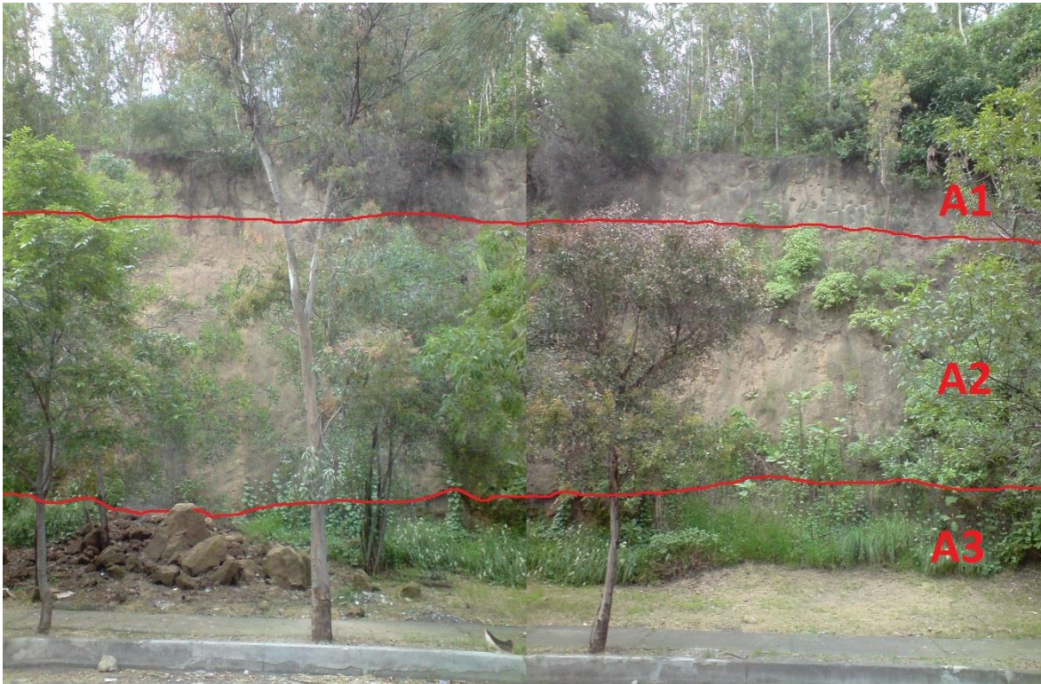
Fig. 29. La parte más alta del talud, se aprecian las 2 unidades superiores y se infiere la inferior.
