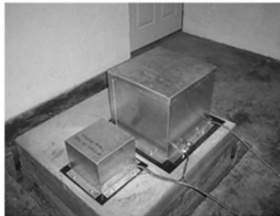
Fig. 1.4. Interior Cuarto de Sensores.
