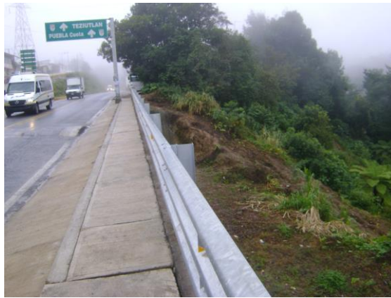
Figura 3.11: Presencia de humedad en el Km 19 de la carretera Teziutlán-Nautla.
