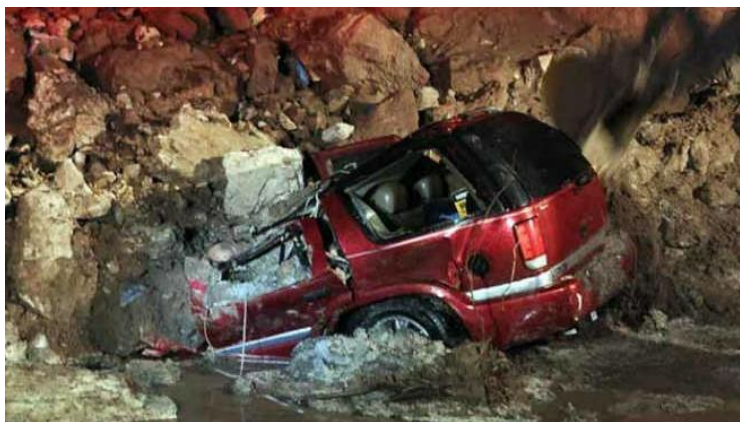
Figura 1.18: Desprendimiento de rocas y suelo en la Autopista México-Querétaro (Fuente: www.unionjalisco.mx ).
