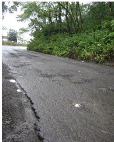
Figura 3.24: Las continuas precipitaciones causan daños en las vialidades (Foto: Felipe Juárez).
