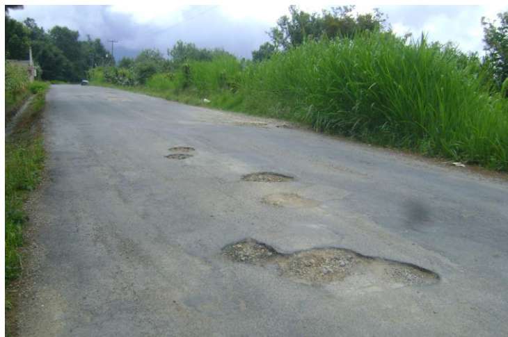
Figura 3.29: Tramo en mal estado Km. 5.
