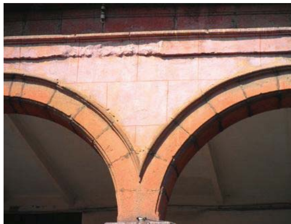
Arcos de la fachada. Posible pintura original, o que la recuerda. 903
