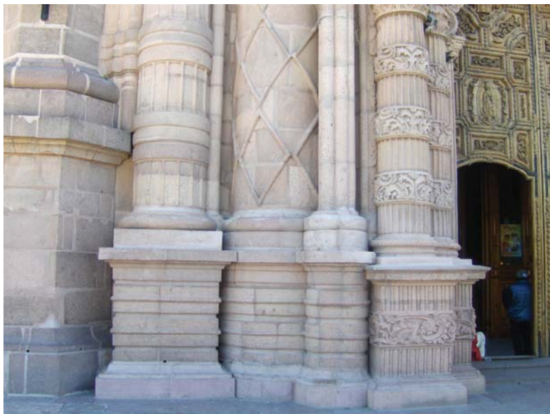
La puerta de entrada da cuenta de la escala del santuario y podemos apreciar el abombamiento de la fachada. 1346
