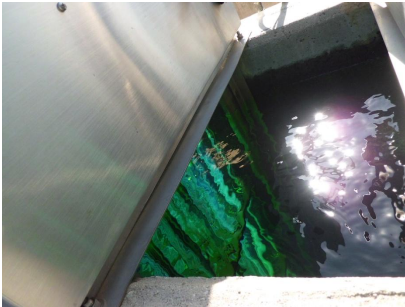
Figura 2.18 – Sistema de desinfección de Cauley Creek.
