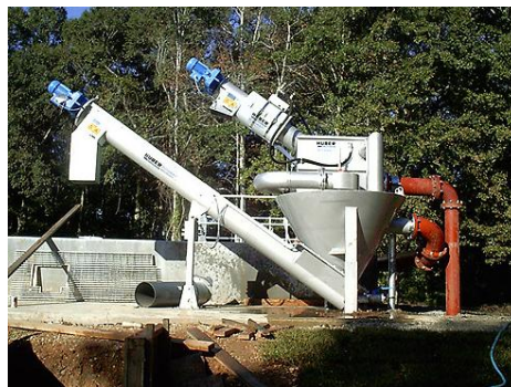
Figura 3.9 – Módulo de pretratamiento. (Hueber Technology, 2011)
