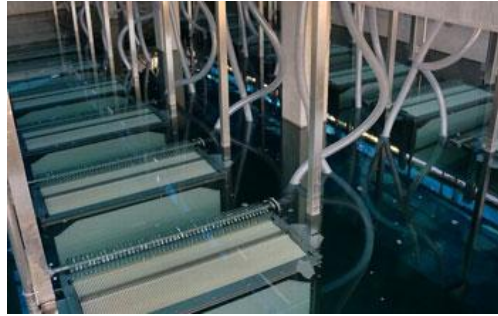
Figura 1.7 – Sistema de membranas planas instalado. (Judd, 2013)
