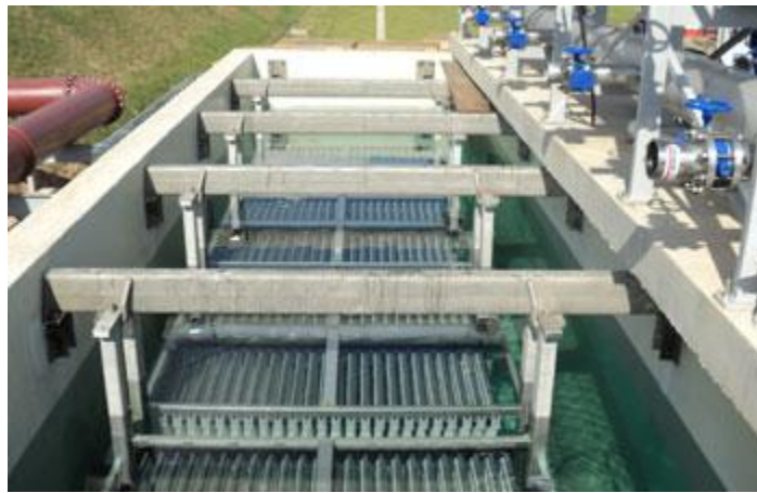
Figura 1.10 – Sistema de membranas de fibra hueca instalado. (Judd, 2013)
