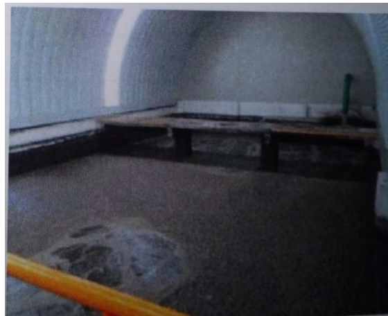
Figura 3.12 –Reactor biológico aerobio operando actualmente en la PTARCA.
