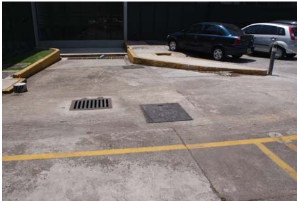
Figura B11.- El pozo de Economía está inmerso en el estacionamiento de profesores.
