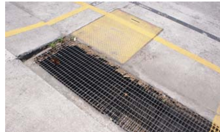
Figura B22.- Rejillas de recolección y canaleta de conducción
