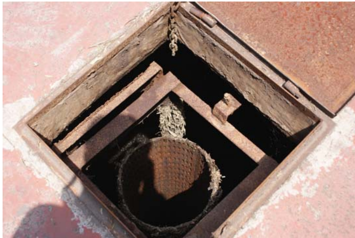
Figura B5.- Ademe de conducción, obsérvese el estado de conservación
