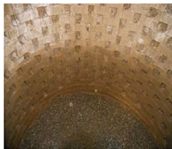
a) Interior de un pozo de absorción
