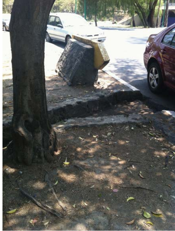
Figura B26.- El Pozo de Beisbol cuenta con canaletas sin rejilla, teniendo obstrucción de restos orgánicos
