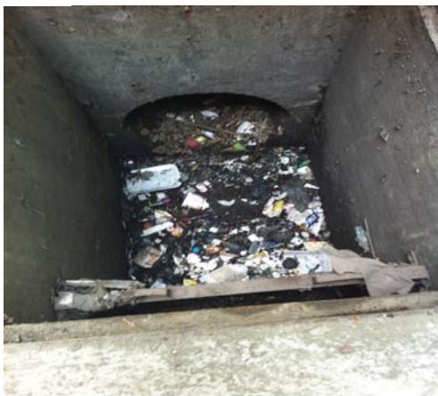
Figura B18.- Trampa de sólidos con exagerada cantidad de restos orgánicos e inorgánicos
