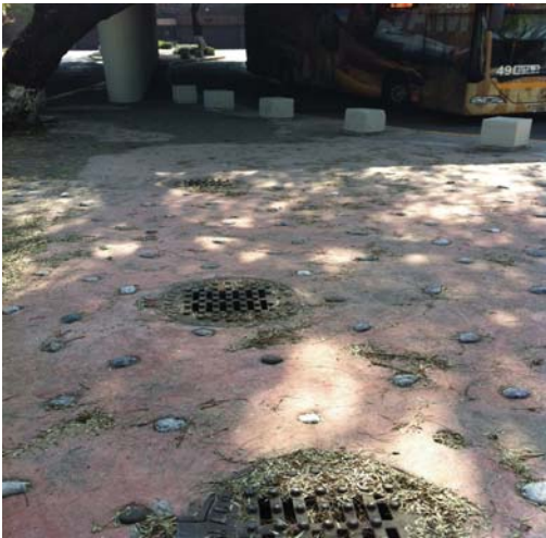
Figura B2.- La presencia de árboles en la zona de recarga al acuífero, afecta con la presencia de materia orgánica y su obstrucción a lo largo del tren de conducción.
