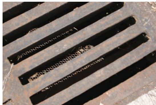
Figura B28.- El Pozo de Beisbol cuenta con canaletas sin rejilla, teniendo obstrucción de restos orgánicos
