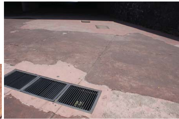
Figura B6.- Rejillas recolectoras de agua pluvial
