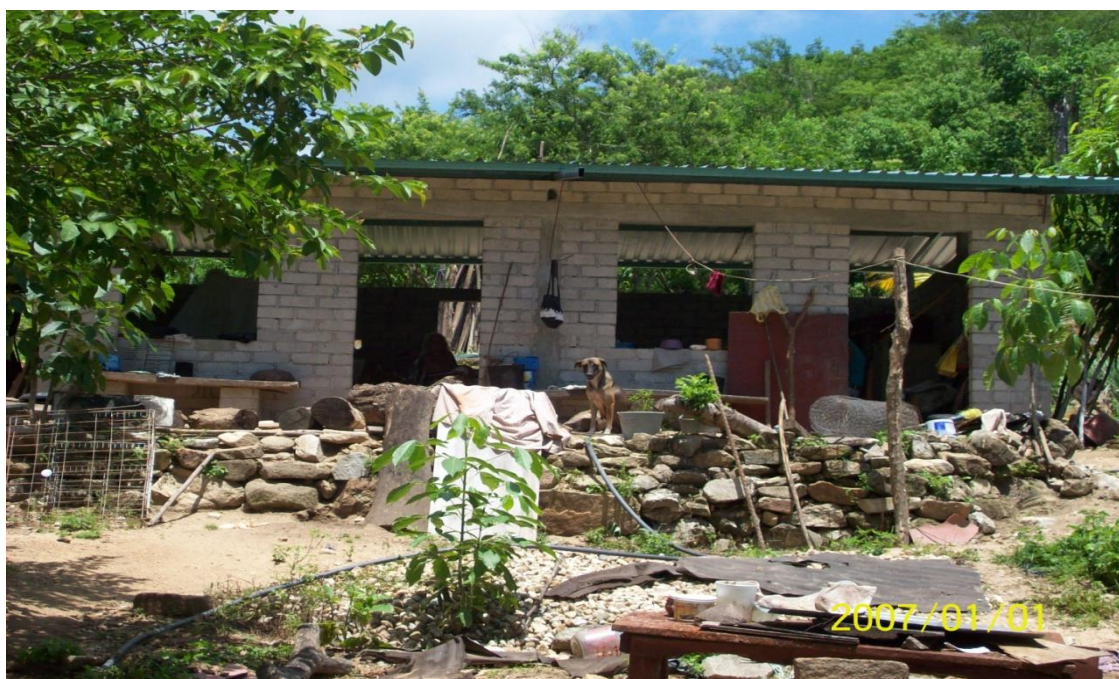
Fig. 13: Éste es el hogar de los ancianos, en la imagen se puede observar que la casa no tiene puertas y ventanas además de la nula accesibilidad para la silla de ruedas. Debajo está el arroyo. . Fotografía tomada por Francisco González, Septiembre de 2012 (Poblado “Los Limones”, Carretera a San Gabriel Mixtepec, Oaxaca).
